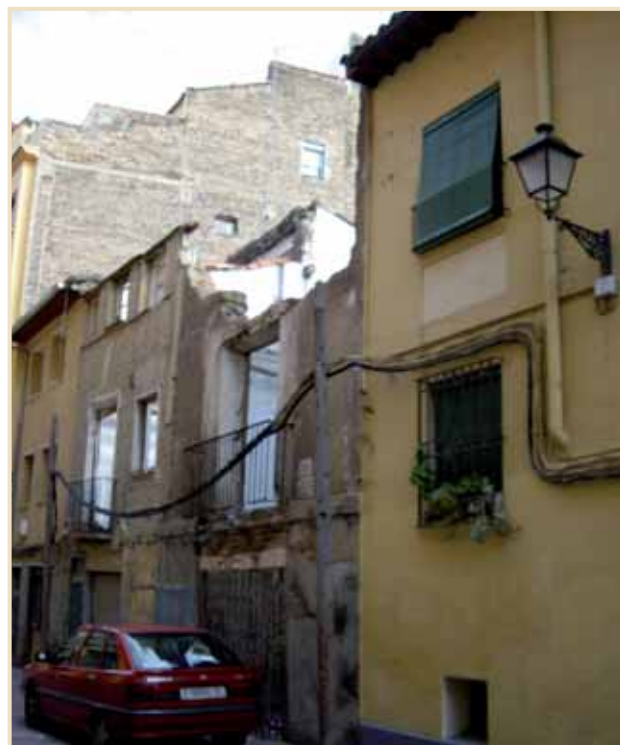
Edificio abandonado: ruina
